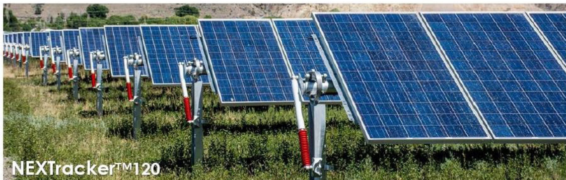
< Figura 2.3 Módulos fotovoltaicos
