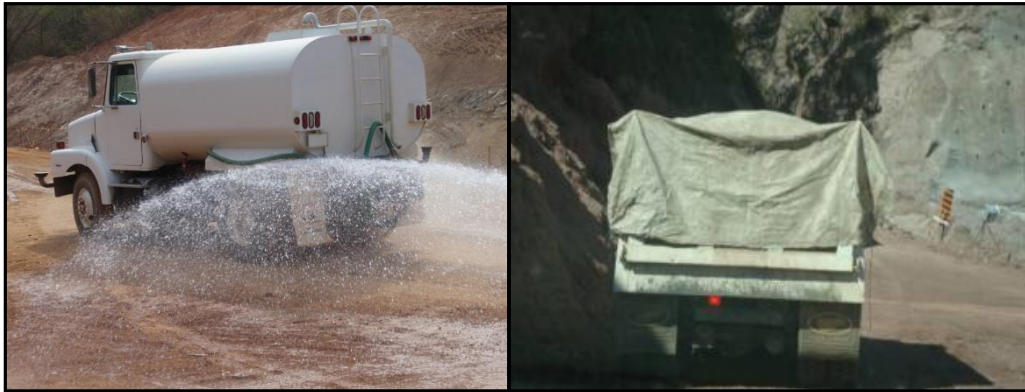
Foto VI.1. Donde se muestra un ejemplo de cómo se debe realizar el riego de las superficies y cubrir los camiones al hacer el traslado de material.
