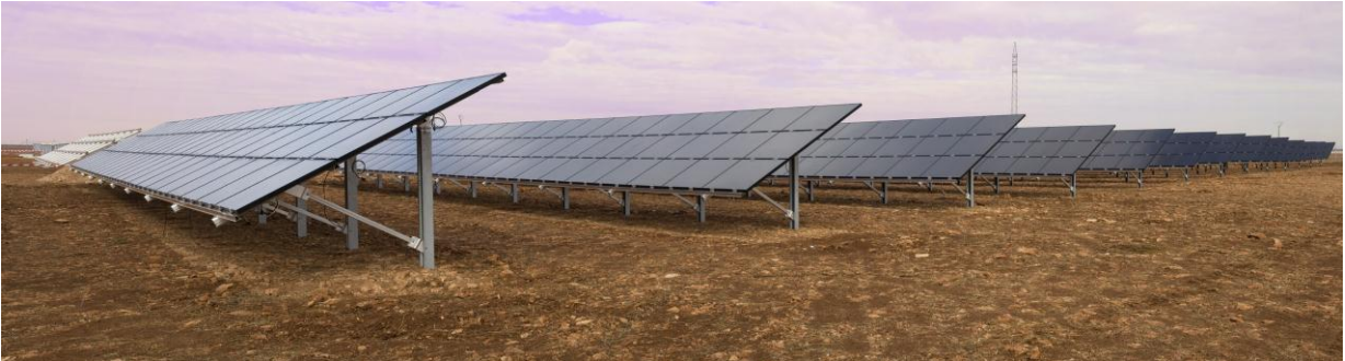
Imagen 1: Ejemplo de módulos fotovoltaicos (campo solar fotovoltaico)
