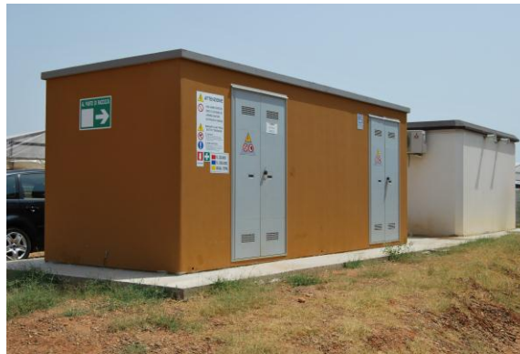
Imagen 3: Centros de transformación a instalar por Fisterra Energy San Fernando S. de R.L. de C.V.
