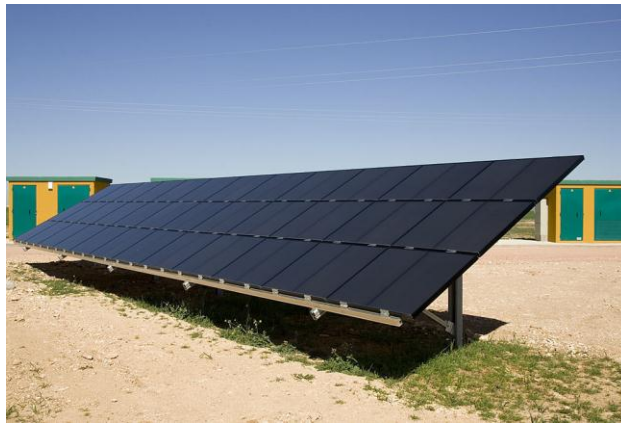
Imagen 11 Visualización de las instalaciones de planta Solar fotovoltaica
