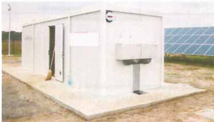
FOTOGRAFÍA IV-27 EJEMPLO DE CASETA DE SEGURIDAD INSTALADA
