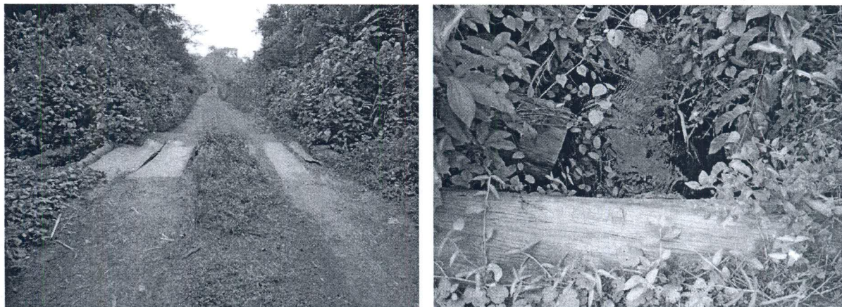
Photo 9 : Pont assurant la libre circulation de l'eau
