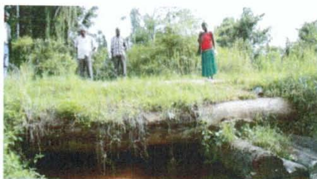
Photo 8 : Pont assurant la libre circulation de l'eau
