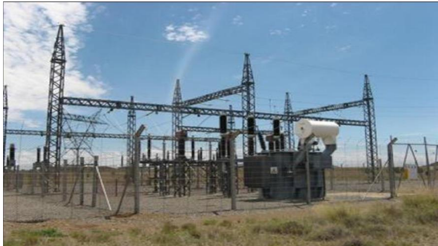
Figura. Subestación elevación 34.5/ 230kV
