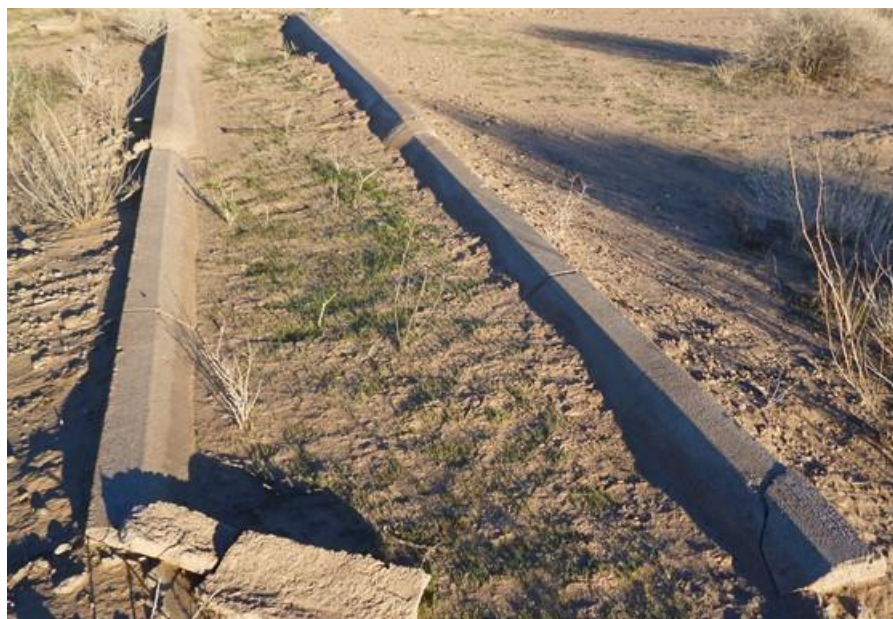
Foto IV.10 Infraestructura de riego azolvada.
