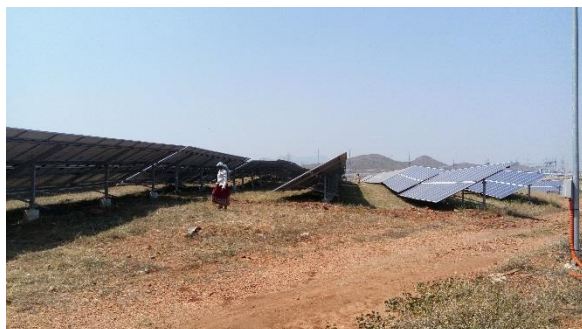
N.P Konta Ultra Mega Solar Park
