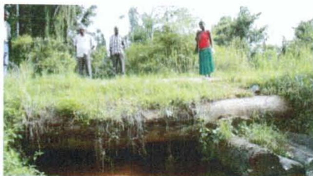
Photo 8 : Pont assurant la libre circulation de l'eau
